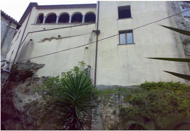
Particolare della facciata esterna del Palazzo poggiate su un grande sperone roccioso
